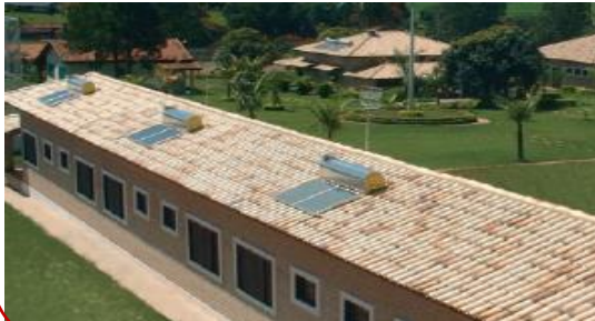
Energia solar térmica
